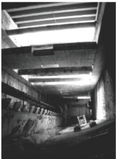
Estación de Ferrocarriles Generalitat de Catalunya, Plaça Espanya, Sabadell, Barcelona. 4.600 m 2 . Promotor GISA. 2011. (AH asociados). Director de Proyecto (Jorge Gambini). Anteproyecto (Jorge Gambini).
