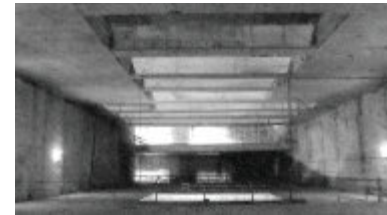
Estación de Ferrocarriles Generalitat de Catalunya, Creu Alta-Eix Macià, Sabadell, Barcelona. 3.000 m 2 . Promotor GISA. 2011. (AH asociados). Director de Proyecto (Jorge Gambini). Anteproyecto (Jorge Gambini)
