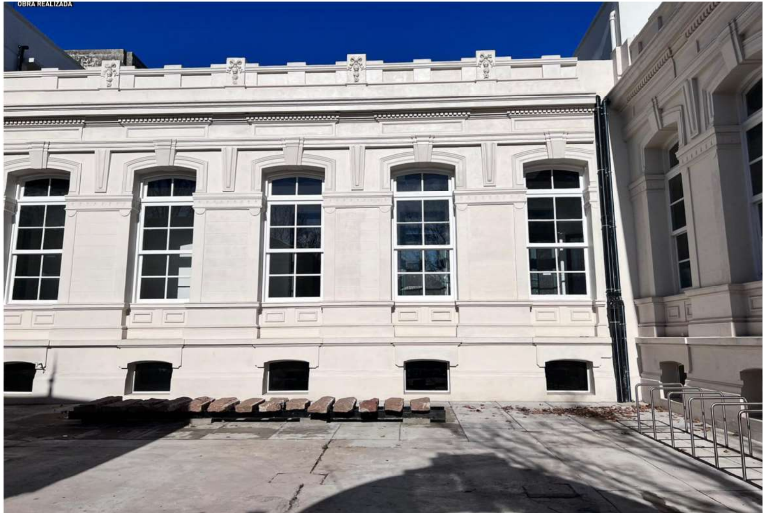
Vista del patio del Anexo I mostrando la recuperación de las fachadas y del suelo para uso común con la demolición de los volúmenes precarios pre-existentes. Se destaca el banco realizado con bloques de granito y perfiles metálicos pre-existentes.
