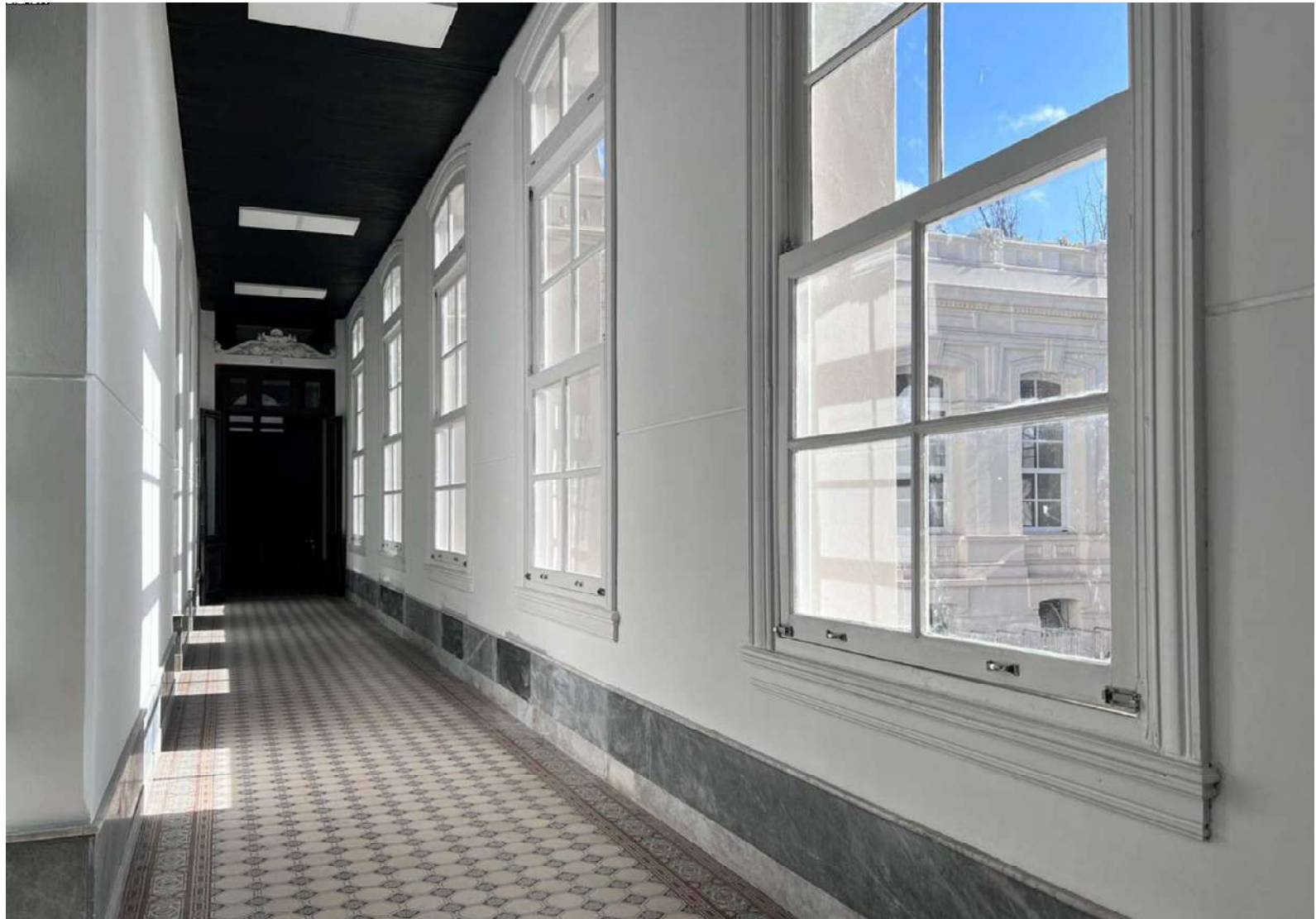
Vista del corredor de planta baja del Anexo I, con nuevo cielorraso y la recuperación de las ventanas a partir de la demolición de construcciones precarias en fachada.
