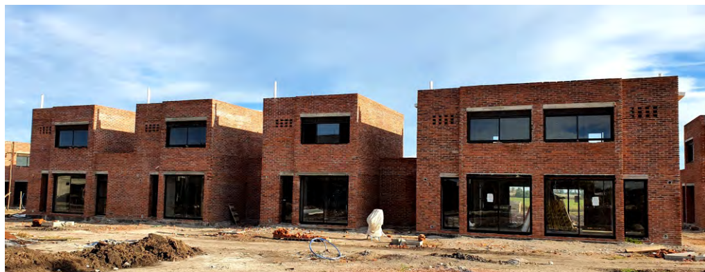
50 VIVIENDAS Y SALON COMUNAL / COOPERATIVA DE VIVIENDA COVIPINO 1 / RINCON DEL PINO - SAN JOSE / EN CONSTRUCCION
