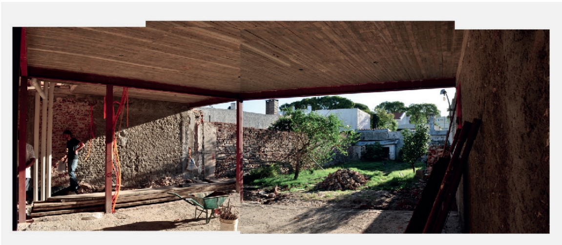
Diseño, Proyecto Básico, Proyecto de Ejecución y Dirección de Obra "Vivienda Río de la Plata", LadoB arquitectura, Junio 2012.
